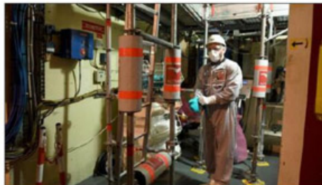
Visite décennale de l'unité n°5 à la centrale du Bugey.
